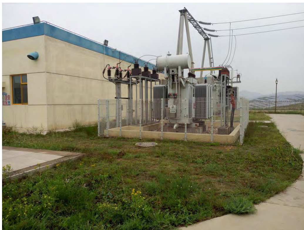
升压站内绿化
