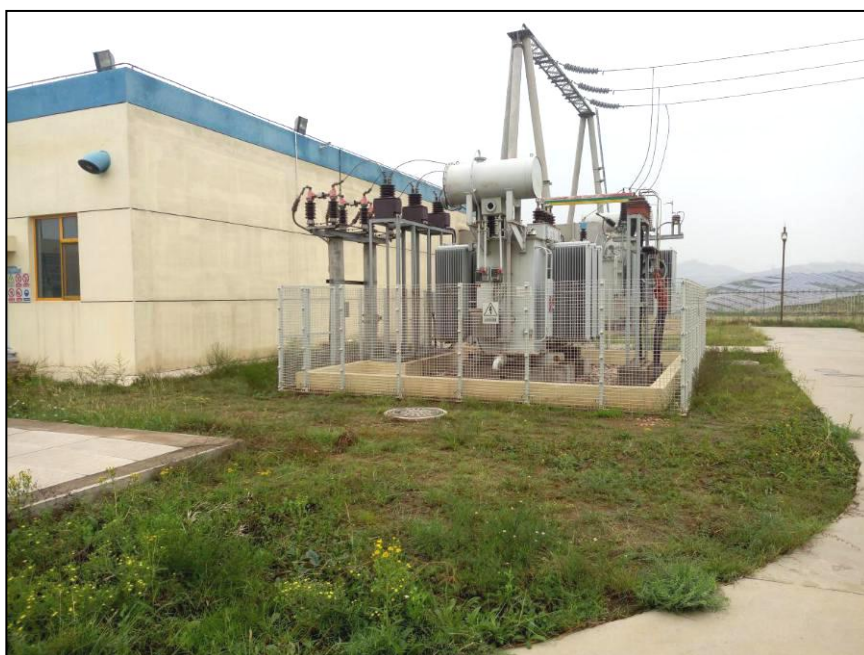
升压站内绿化
