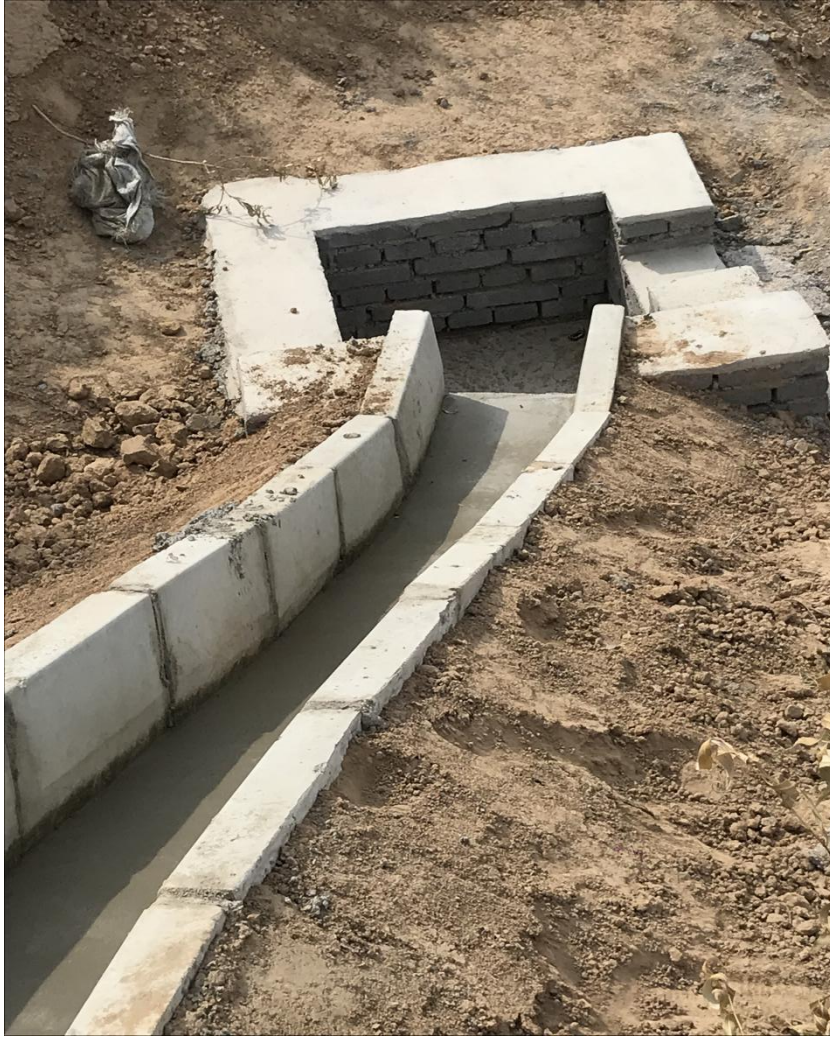
排水沟末端水窖
